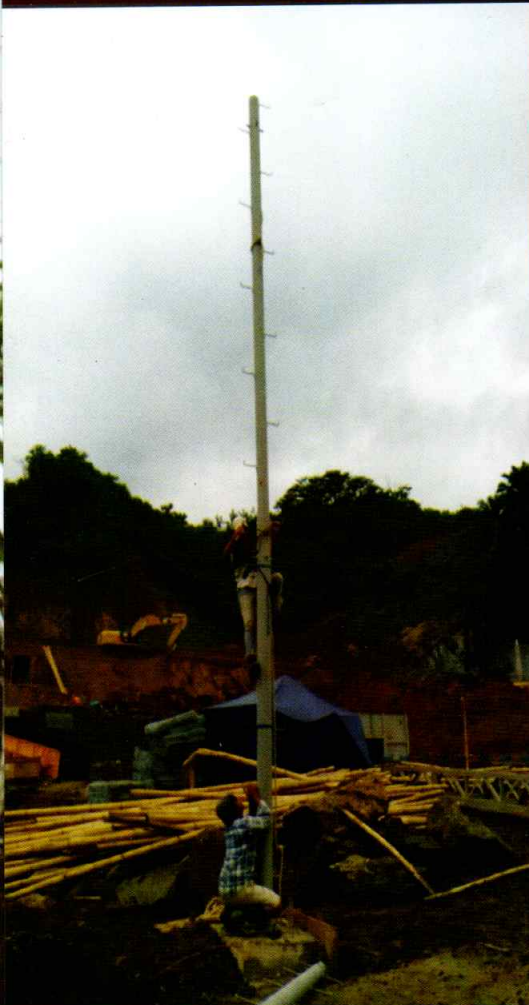
Instalasi Taing di Area Terbuka BLUECRN2 Curug Tangerang
